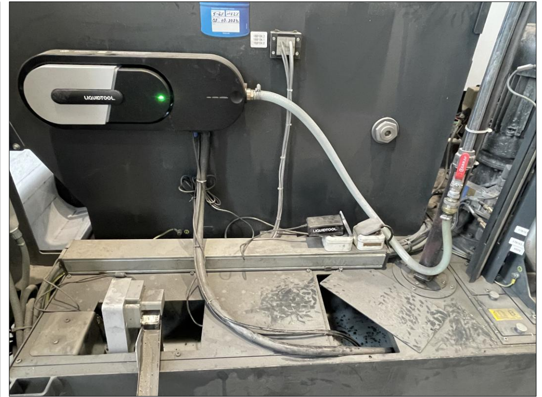
Капаците над резервоара за COT със сензора за автоматично пълнене
